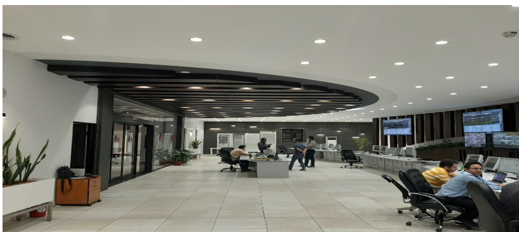
شکل ۳. چیدمان افراد و منابع روشنایی اتاق کنترل نیروگاه
