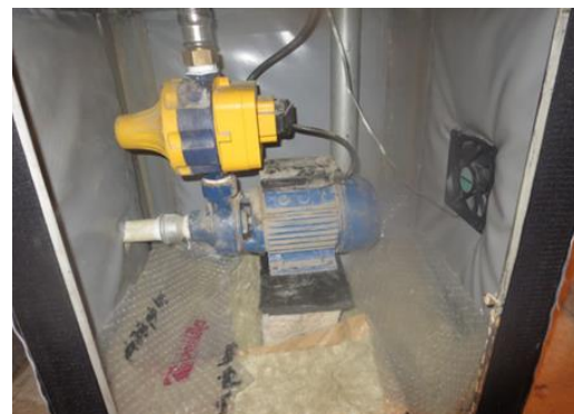
شکل ۳- نمای داخلی محفظه آکوستیک به همراه محل نصب سیستم تهویه
